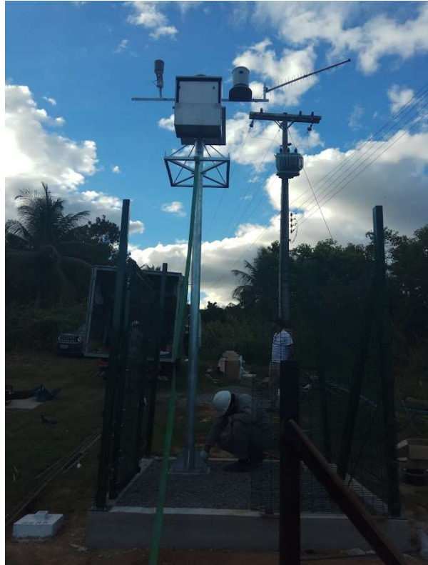
Figura 11: Exemplo de UTR em poste com os suportes para apoio de escadas
