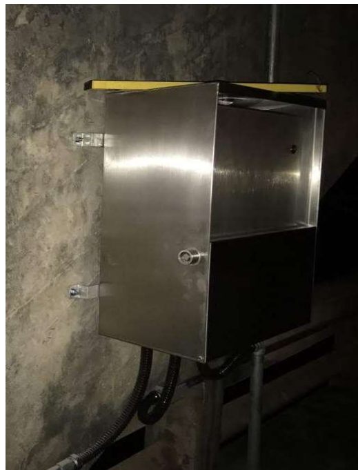
Figura 10: Exemplo de painel com a segunda tampa de segurança, lacrada por parafuso antifurto, que serve como suporte para notebook.
